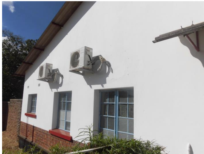
nieuwe airco's bij gerenoveerde operatiekamers
