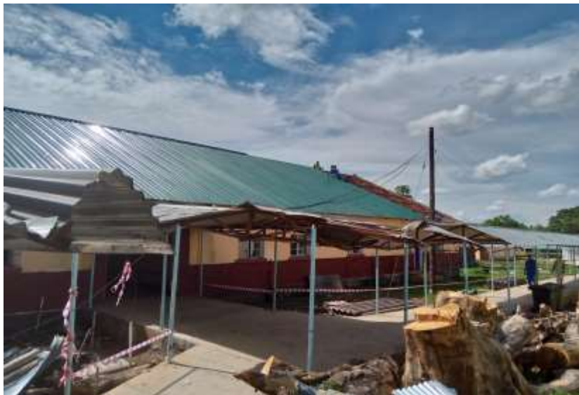
Vervanging daken en schade aan gangpad door omgevallen boom.
